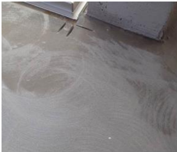
Onvoldoende opgeruwd (diamantschuren)
